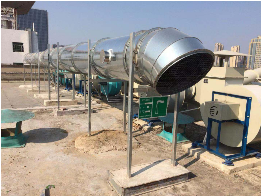
实验室废气处理设施
